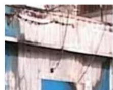
разрушение красочного слоя
